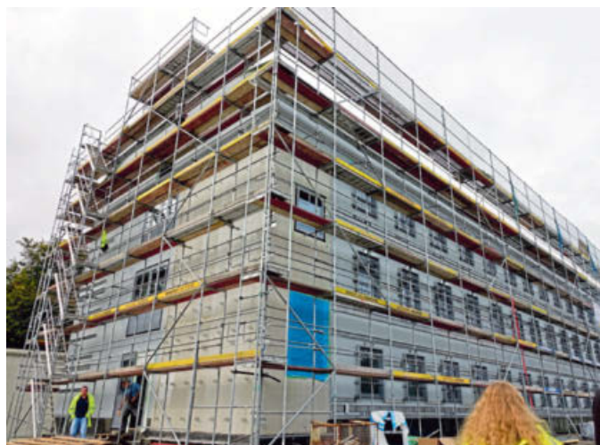
Aus insgesamt 131 vorgefertigten Modulen wird das Hafthaus 8 gefertigt. Auch die Außengitter wurden bereits vorinstalliert.
