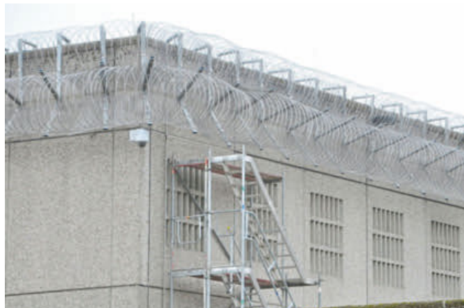
Extra stark gesichert: Das Dach des baustellennahen Hafthauses 1 soll Gefangene nicht zur Entweichung verleiten.
